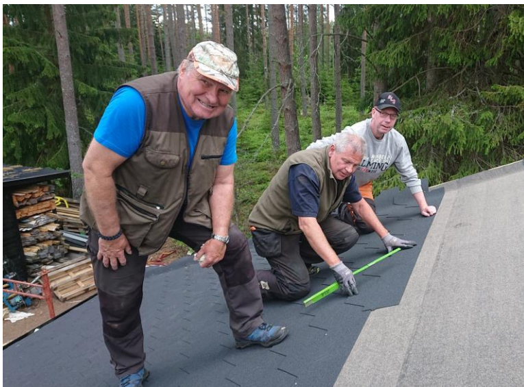
Här lägger Roger Dahlsten, Christer Dahlsten och Roger Liljemark shingel på taket, det blev riktigt snyggt och bra.
